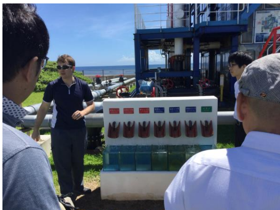
海洋温度差発電施設
